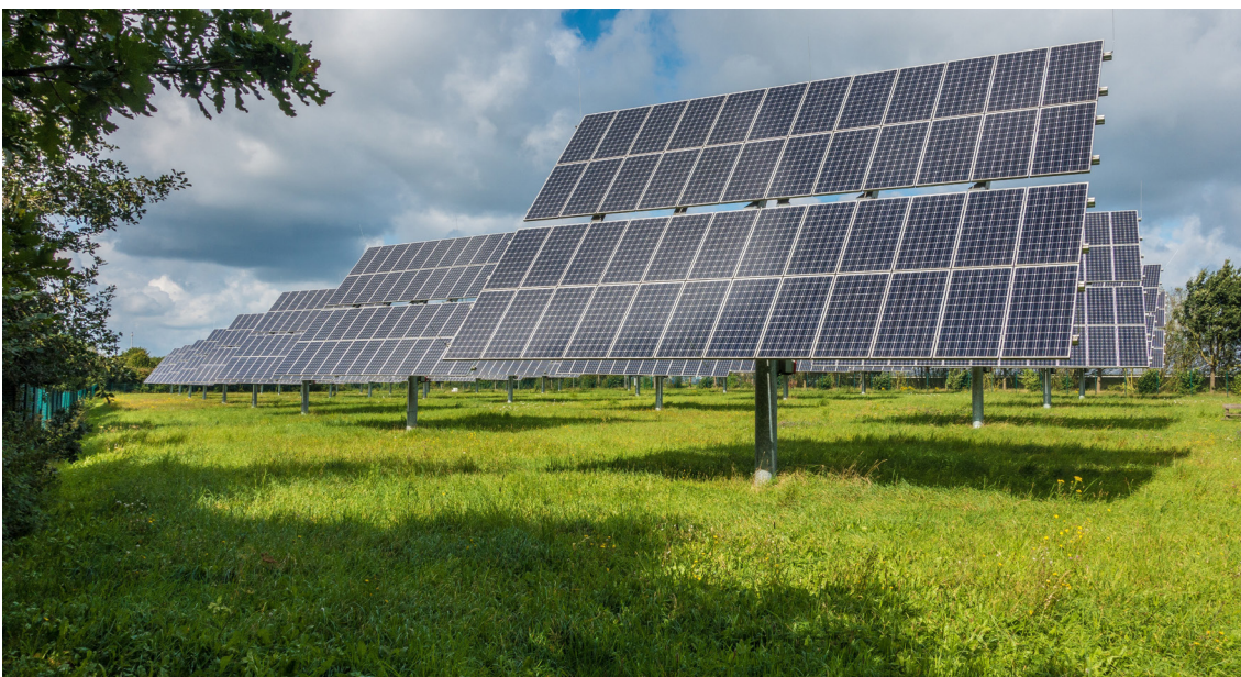
Abb. 88 Solaranlagen mit Nachführungssystem, das die Solarmodule der Photovoltaikanlage dem Sonnenstand und der optimalen Himmelsrichtung anpasst (Pixabay-Lizenz)
